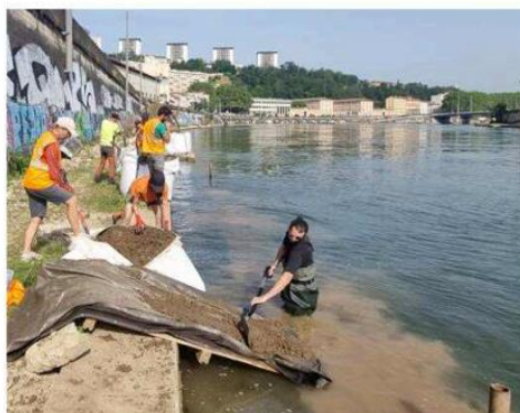
À droite dans l'eau, le gabiodiv en construction, à gauche le chemin de halage dont le sol est progressivement rendu perméable et où les arbres et plantes locales retrouvent une raison d'exister. Photo David Tapissier
