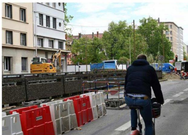
Les travaux de réseaux ont commencé autour de la trémie rue Garibaldi : une seule des deux contres allées est ouverte à la circulation. Photo Frédéric Chambert
