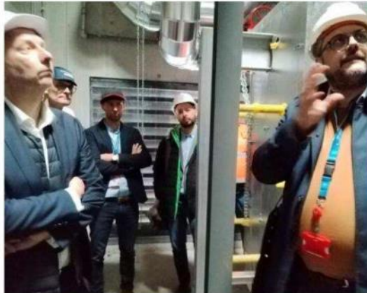
Visite de la chaufferie de l'Hôpital de la Croix-Rousse dans le cadre de l'inauguration du raccordement de l'établissement hospitalier au réseau de chaleur Plateau Nord.
