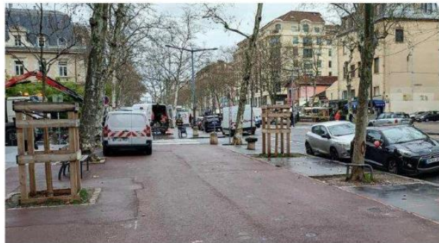
Le chantier devrait s'étendre sur deux ans et être réalisé par tronçon. Photo Yves Le Flem
