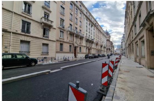
Rue Waldeck-Rousseau, la voie lyonnaise n° 2 est déjà bien avancée. Tout le stationnement à droite (côté pair) a été supprimé et en face, des îlots sont prévus pour abriter des plantations (côté impair). Photo Nadine Micholin
